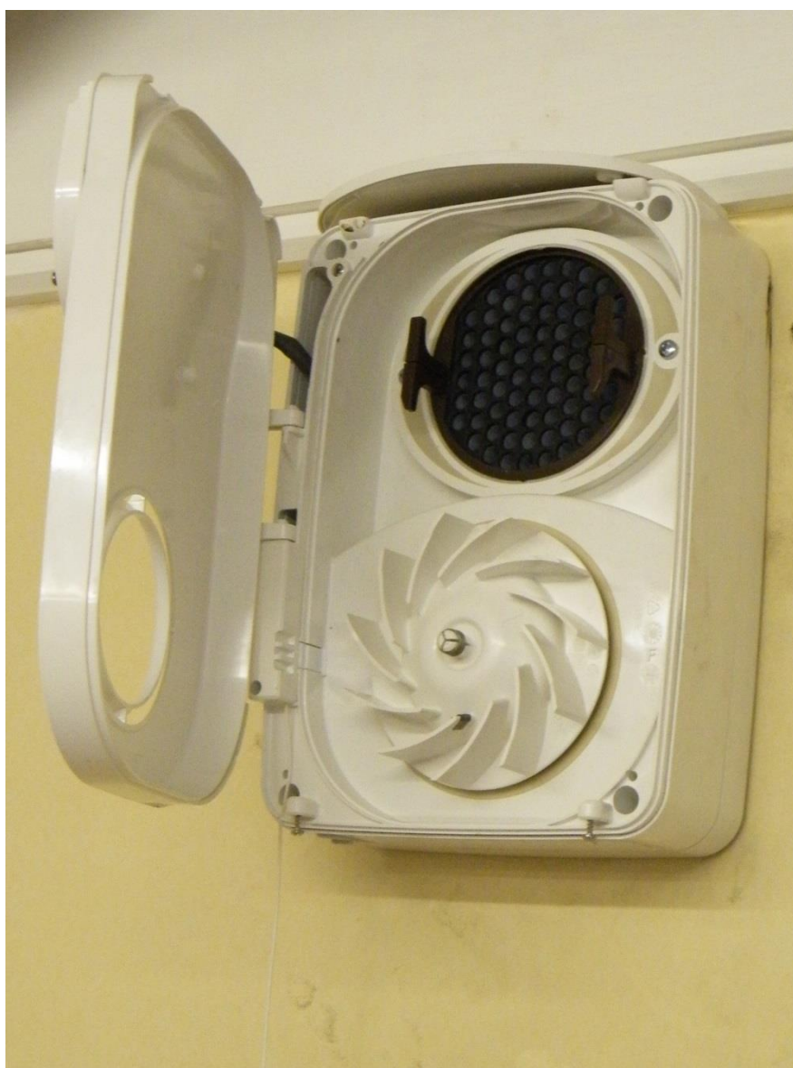
Heat recovery fan
